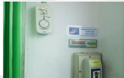
กำหนดช่วงเวลาเปิด-ปิดเครื่องปรับอากาศ
