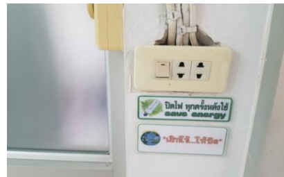
ป้ายกระตุ้นเตือนประหยัดพลังงานไฟฟ้า
