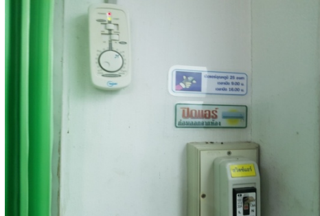
กำหนดช่วงเวลาเปิด-ปิดเครื่องปรับอากาศ
